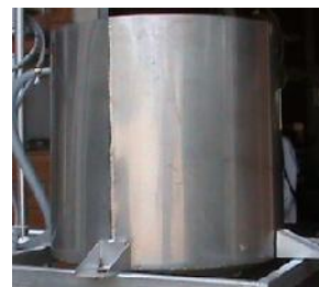
(ข) ถังล้างและแยกไขมัน
