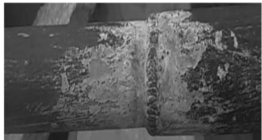
รูปที่ 7 การกัดกร่อนของเพลลาบริเวณรอยเชื่อม
